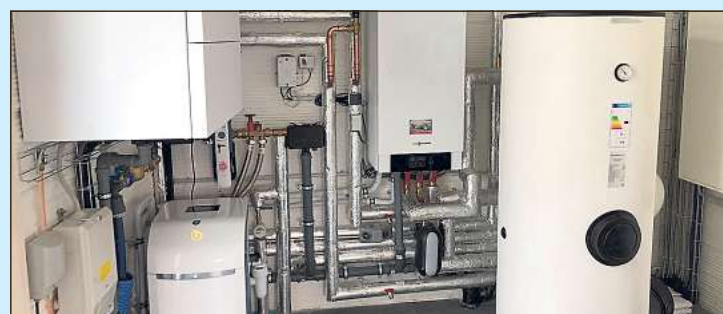
Wärmepumpenanlage und kontrollierte Wohnraumbelüftung im 3D-Druckhaus in Beckum.
